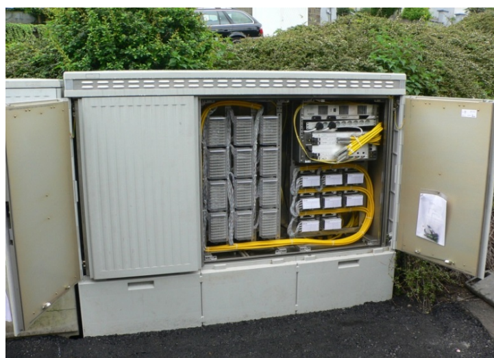
Εικόνα 5.1.4.1.β: Εξωτερικό DSLAM
