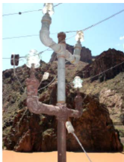
Εικόνα 5.1.α: Εγκατεστημένο τηλεφωνικό δίκτυο
